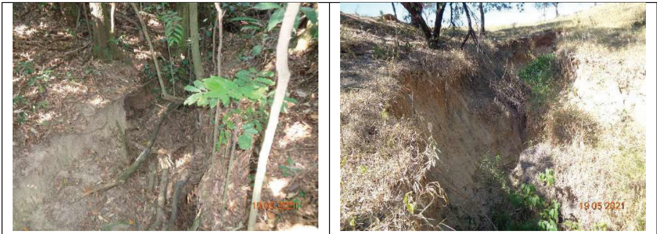
Foto 9: e Foto 10: Em ambas as fotos (N4 e N5), canal seco em talvegue que corresponde em dreno de águas superficiais.
